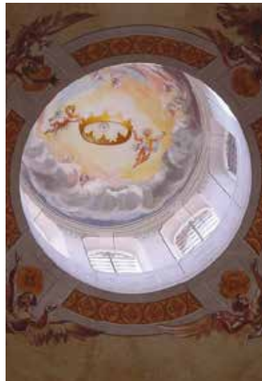
Současný stav kupole kostela Zvěstování Panně Marii v Mariánské Týnici.
