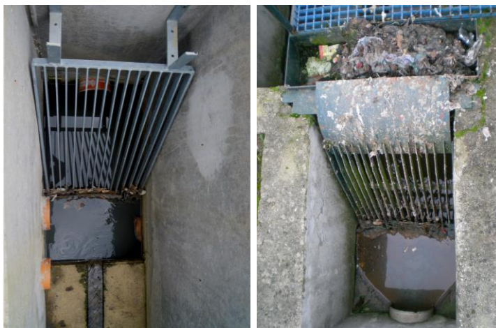
Obr. 6. Ručně stírané česle. Vlevo KČOV Horušany u Přeštic, vpravo KČOV Slavošovice u Třeboně (nad česlemi je odvodňovací plošina, na kterou se shrabky deponují před odstraněním do kontejneru). Foto Jan Vymazal.
