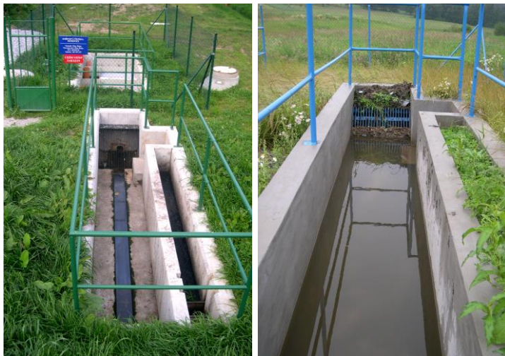
Obr. 14. Česle a horizontální lapák písku a štěrku na KČOV Petrovice u Havlíčkova Brodu (vlevo) a ve Skleném u Žďáru nad Sázavou (vpravo). Na levé straně je ukázka dobře provozovaného lapáku, vpravo ukázka lapáku bez řádné údržby. Foto Jan Vymazal.
