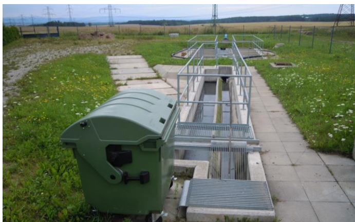
Obr. 9. Typická sestava předčištění pro kořenovou čistírnu na jednotné kanalizaci – česle, lapák písku a v pozadí štěrbinová nádrž. KČOV Libnič. V popředí je kontejner na ukládání shrabků. Foto Jan Vymazal.
