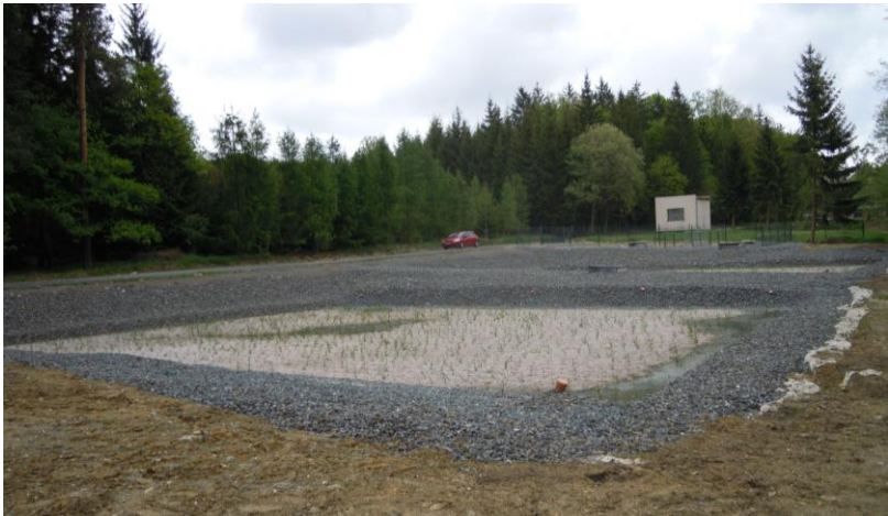
Obr. 27. Kořenová čistírna Horušany u Přeštic v květnu 2012. Foto Jan Vymazal.
