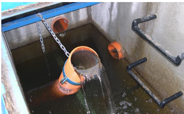
Obr. 10. Odtoková plastová trubka zavěšená na řetízku, kterou se udržuje výška vody ve filtračním loži na KČOV Sklené. Foto Jan Vymazal.
