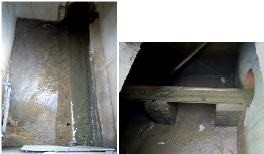
Obr. 5. Odlehčovací dešťová komora na jednotné kanalizaci. Vlevo jednostranný boční přeliv (KČOV Libnič), vpravo oboustranný boční přeliv na KČOV Slavošovice. Foto Jan Vymazal.
