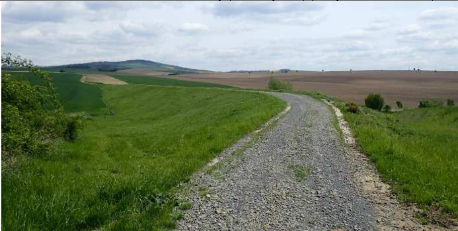
Hráz suché protékané retenční nádrže "Roštoutky" s bočním kamenným bezpečnostním přelivem se zatravněnou zátopou v k.ú. Uhřice (okres Vyškov) (zdroj: VÚV TGM, v.v.i.)
