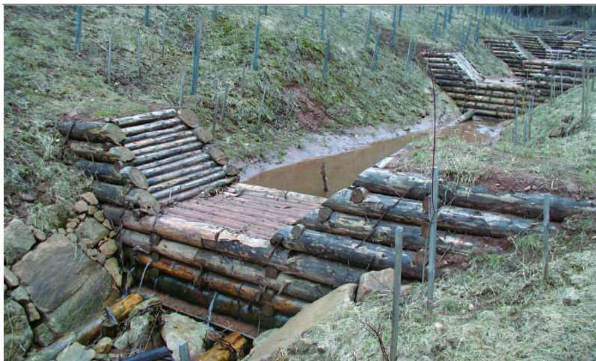
Soustava konsolidačních přehrážek, srubová konstrukce ze smrkové kulatiny, zdroj 15
