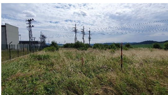
Lada s dřevinami pod rozvodnou
