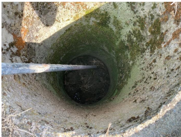
Meliorační šachtice na orné půdě jižně od zástavby Beňovy, dno pokryté sedimenty, průtočný profil značně omezen, téměř neprůtočné
