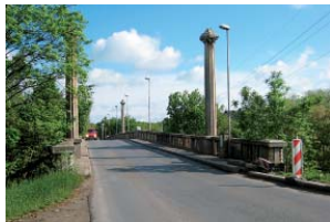
Stavba provizorních mostů v Jateční ulici je ve velmi špatném stavu a doprava z něj bude odvedena na dva provizorní mosty. FOTO RICHARD BENEŠ
