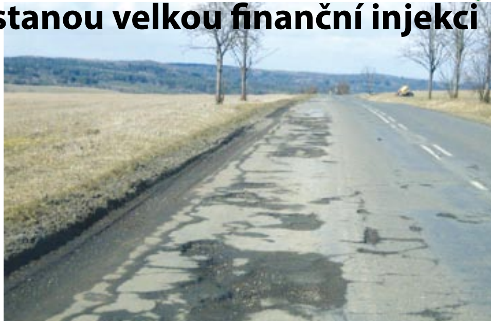
Na stavu silnice II/230 vedoucí z Nepomuku do Přeštice se výrazně podepsala loňská zima. Povrch vozovky je plný výtluků a prasklin, rekonstrukce je nezbytná.
